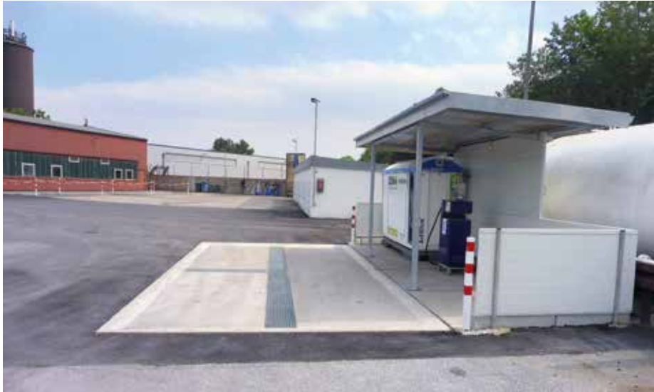
Die FUCHS Stahlbeton-Tragwanne für Betankungsflächen wird durch Großbetonplatten und Hochbordsteine ergänzt
