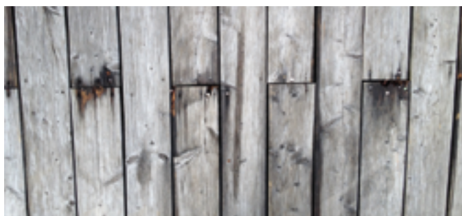
Die Ausführung von Längsstößen auf nur 1 Unterkonstruktion ist nicht fachgerecht.
