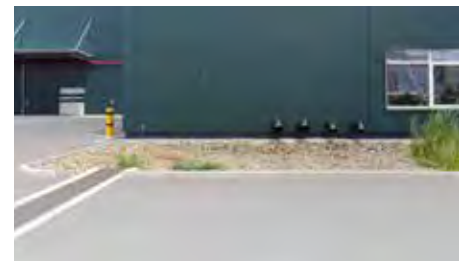
Das anfallende Wasser des 20.000 qm großen Flachdachs wird ebenfalls über die BIRCOsir-Rinnen auf dem Gelände in die Versickerungsmulden geführt
